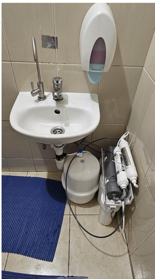
Slika 6. Primjer instaliranog filtracijskog sustava u vrtiću
